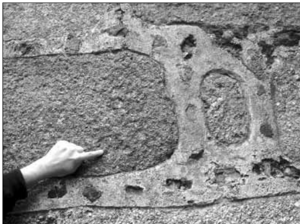
Lámina 2. Detalle de las cintas biseladas y los pequeños fragmentos de pizarra puestos de plano en las fábricas del muro A.2
