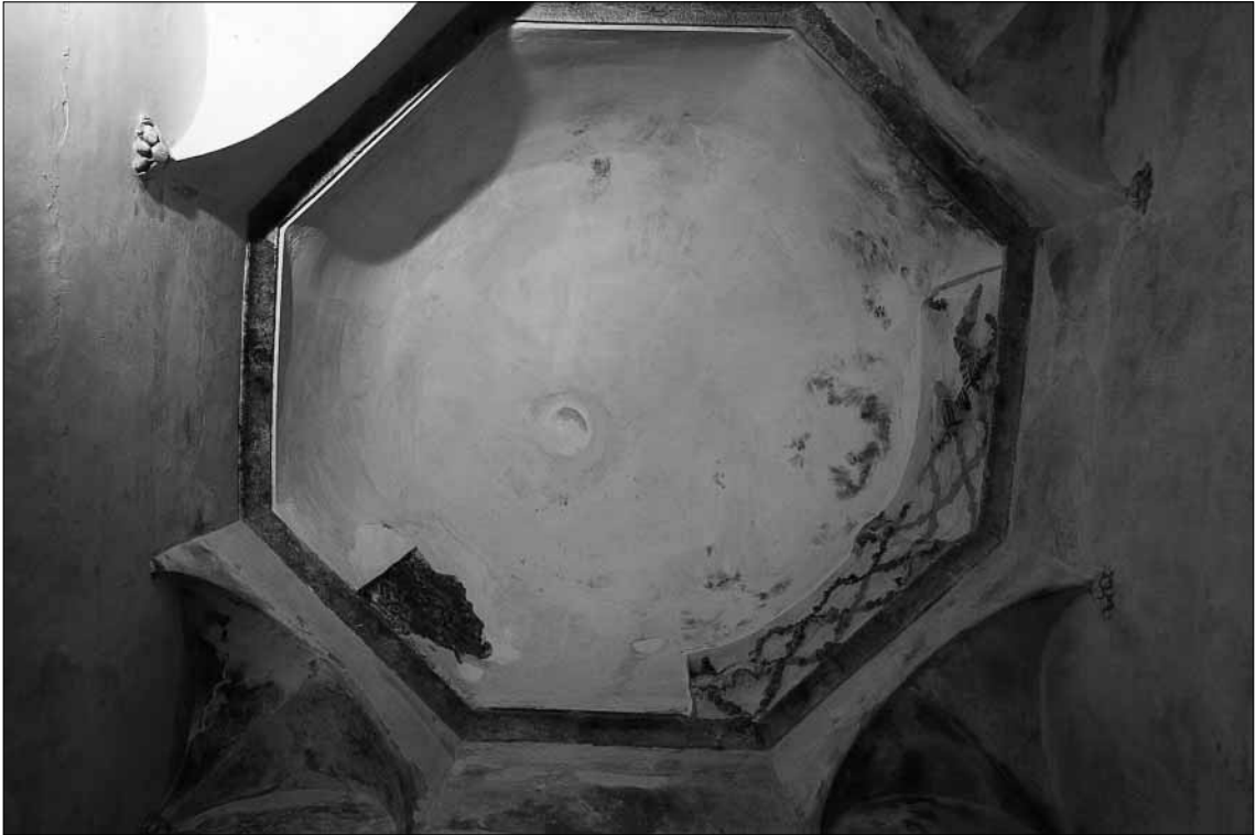
Lámina 4. Vista general de la bóveda de cubrición del espacio principal de la torre.
