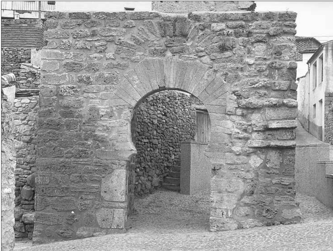
16. La reciente restauración de la Puerta del Barrio, realizada con el loable propósito de proteger su integridad, ha producido su descontextualización, al suprimir el paso bajo la misma
