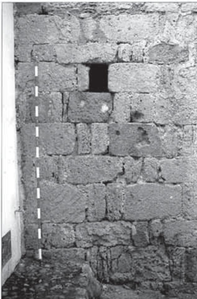
Lámina 7. Detalle de fábrica de sillería a soga y tizón en cara NE de la torre. Obsérvese el tragaluz formado por la eliminación de un tizón.
