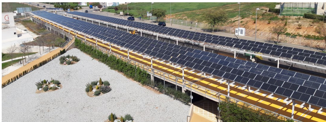
Aparcamiento del CCT Linares – Autoconsumo – 234 kWp
