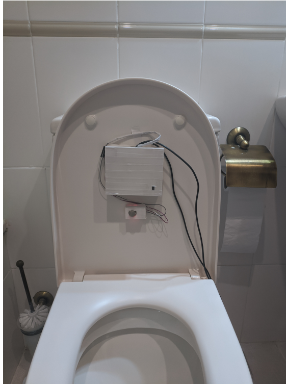
Figura 61: Dispositivo instalado en el inodoro.
