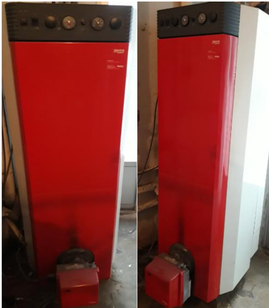
Ilustración 24: Caldera central ROCA CPS 70. Gasóleo-C. Fuente: Propia.
