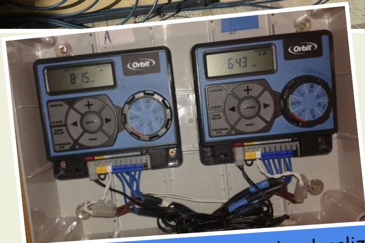
Sistema de riego automatizado y localizado
