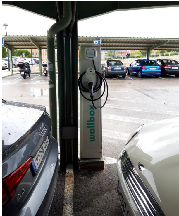
Ilustración 24: Punto de recarga de vehículo eléctrico en el campus Las Lagunillas. Fuente: Elaboración propia
