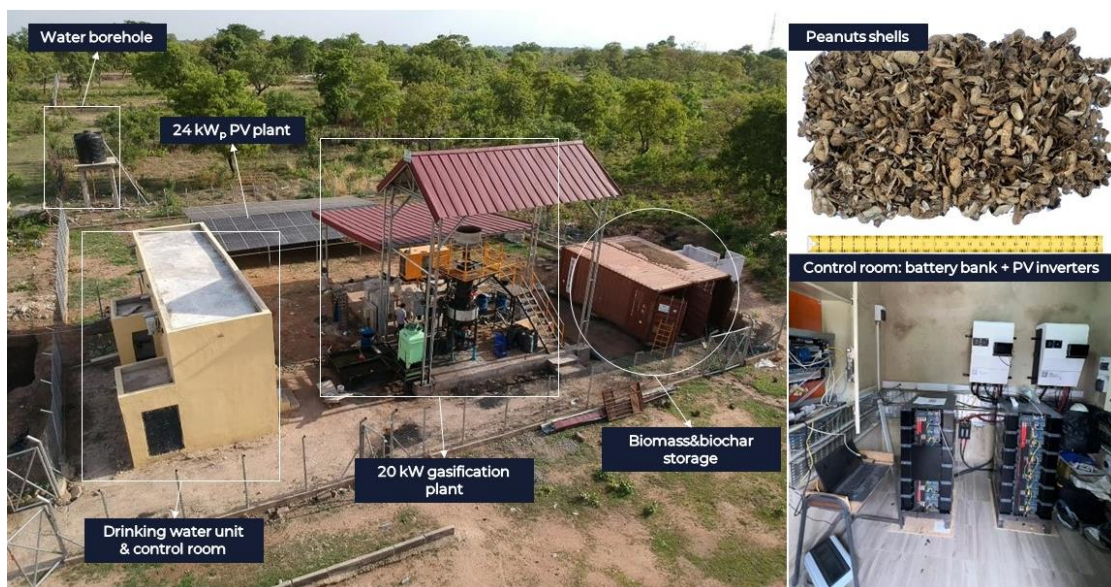
Figura 1. Planta de energía en Ghana.
